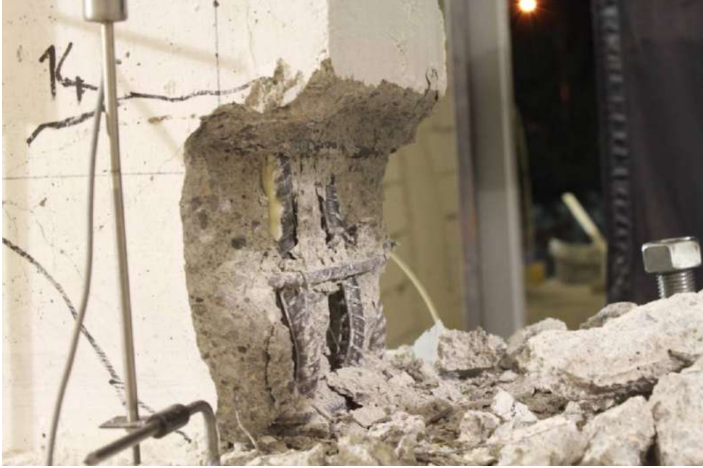
(h) Kolon diplerinde dökülen kabuk betonu ile beraber boyuna donatı burkulması.
