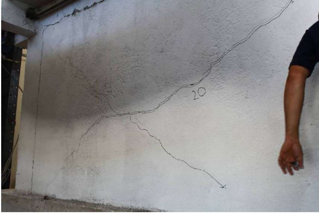
(b) Duvar arkasında oluşan diyagonal çatlaklar.
