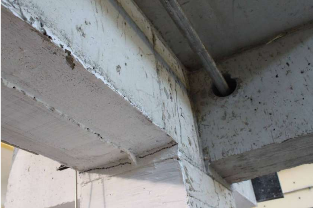
(b) Kiriş-birleşim ara yüzünde oluşan ilk kılcal eğilme çatlakları.
