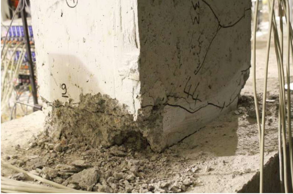
(f) Kolon diplerindeki ezilen kabuk betonunun dökülmeye başlaması.
