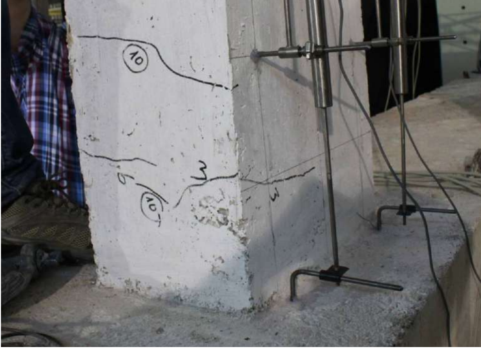
(c) Kolon diplerinde gözlenen kılcal eğilme çatlakları.
