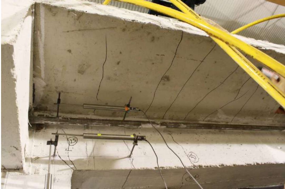
(e) Döşemde görülen eğilme hasarı.
